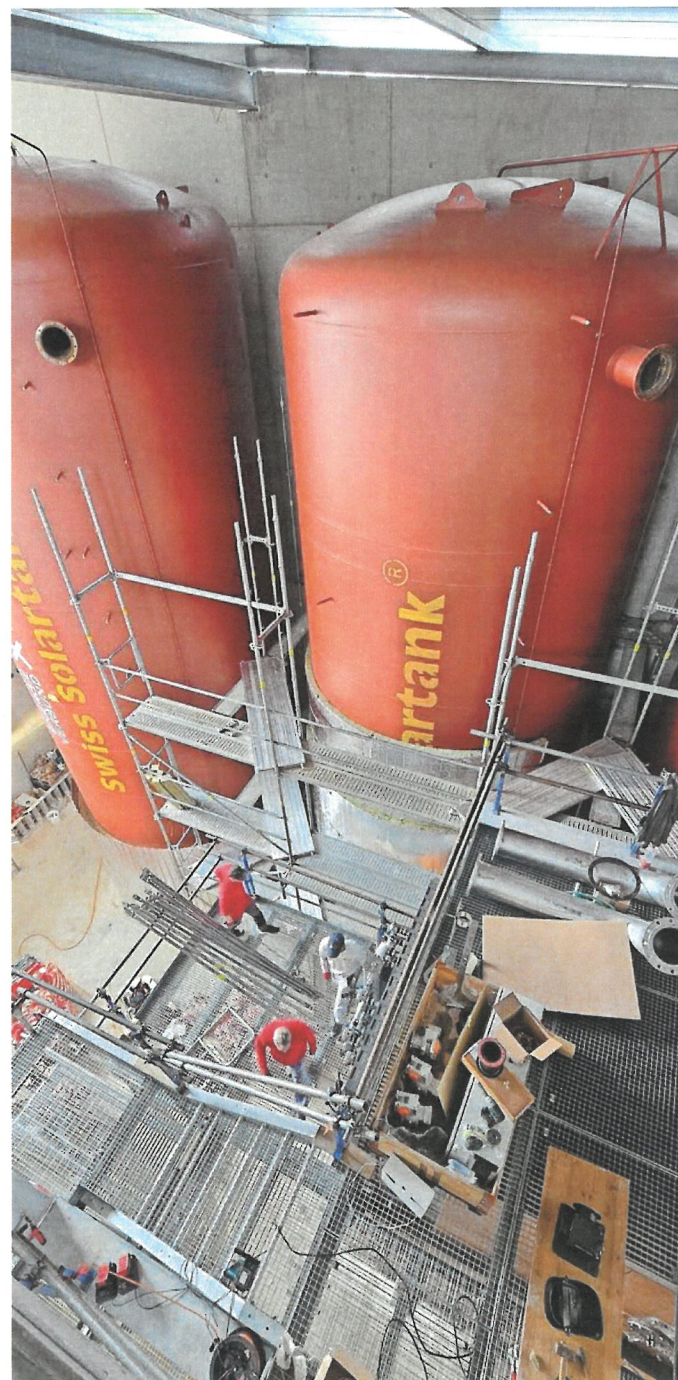
Die Energiezentrale Gruben ist für einen künftigen Ausbau gerüstet. BILDER ZVG
